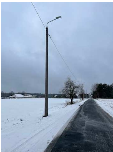
Fot. 7. Oświetlenie ulicy Akacjowej
