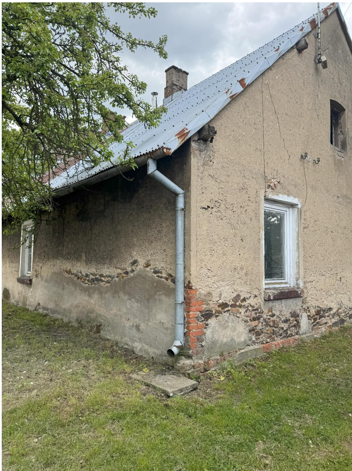
Zdjęcie 4. Stan przestrzeni zdegradowanej na terenie Gminy Konopiska
