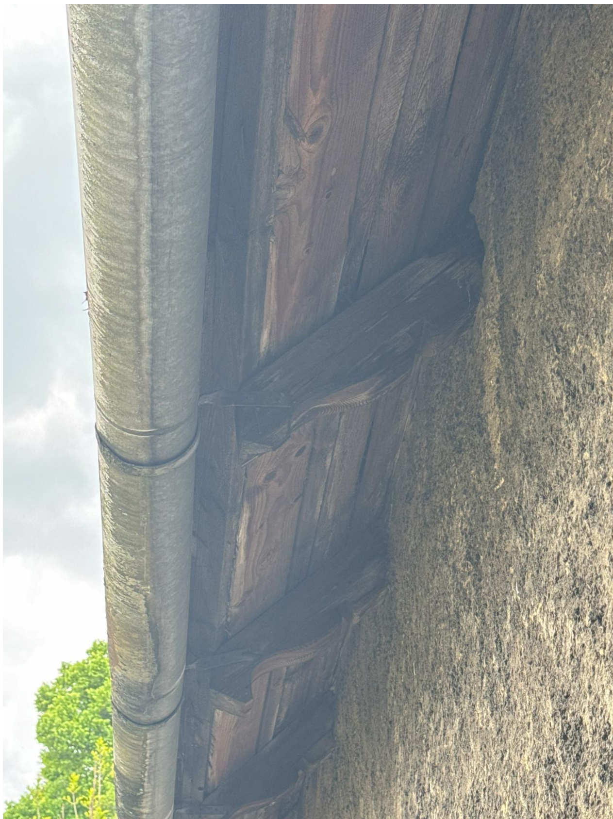
Zdjęcie 5. Stan przestrzeni zdegradowanej na terenie Gminy Konopiska
